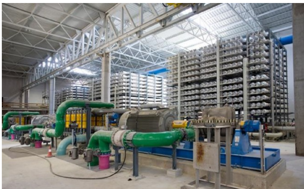
Desaladora de Torrevieja
