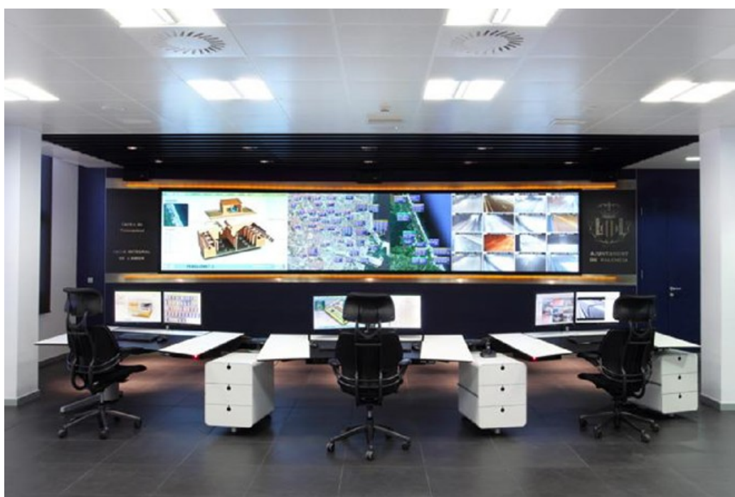
Centro de control del Saneamiento de Valencia
